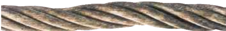
Rys. 16 Miejscowe zmniejszenie się średnicy liny; splotki zewnętrzne zapadły się wskutek rozpadnięcia się rdzenia włókiennego – uzasadnienie natychmiastowej wymiany.
