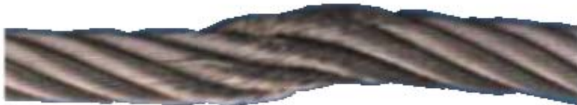
Rys. 15 Lina stalowa, która została podczas instalowania załamana i pozostawiona w eksploatacji. Wynikiem tego jest miejscowe starcie oraz rozluźnienie drutów – uzasadnienie natychmiastowej wymiany.
